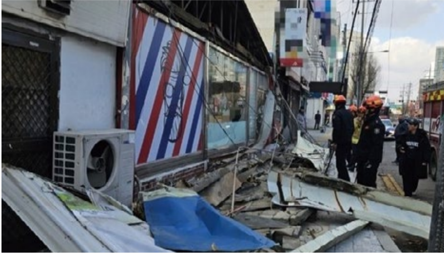
무단 설치된 간판이 추락하면서 사망 사고가 발생한 의정부시 호원동의 현장 모습.
